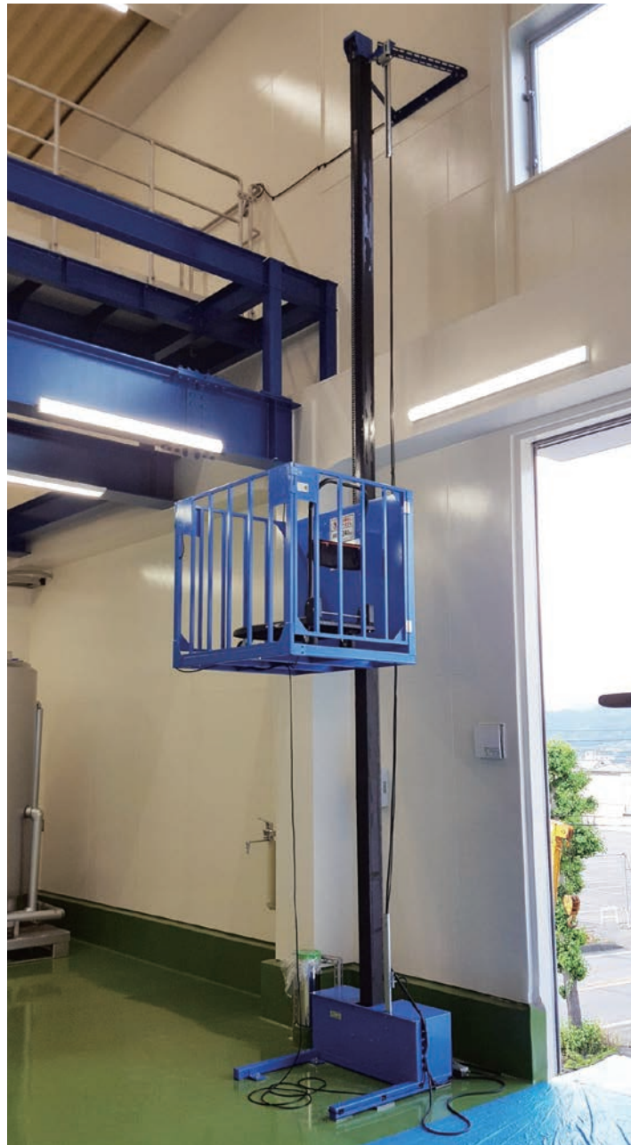
1階～2階・工場に設置
