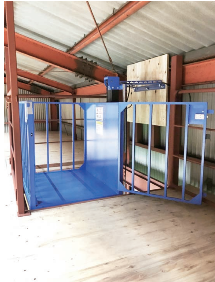
1階～2階・倉庫に設置
