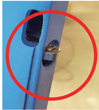
カゴ扉感知装置
